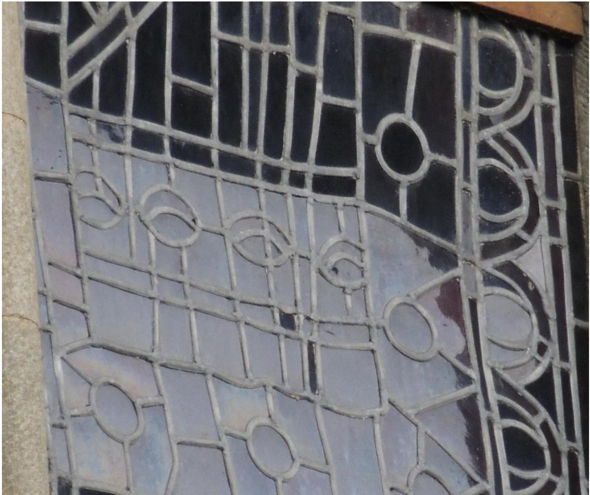
Figur 28, Sterkt deformert glassmalerifelt, som likevel virker solid ved førstegangsundersøkelser
