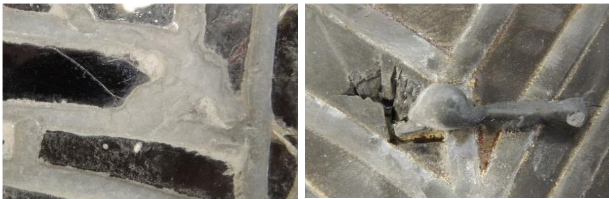
Figur 25, Sementholdig kitt brukt for å tette hull i glass (foto til venstre). Til høyre ser vi innsiden av glassmaleriet ved samme skade.
