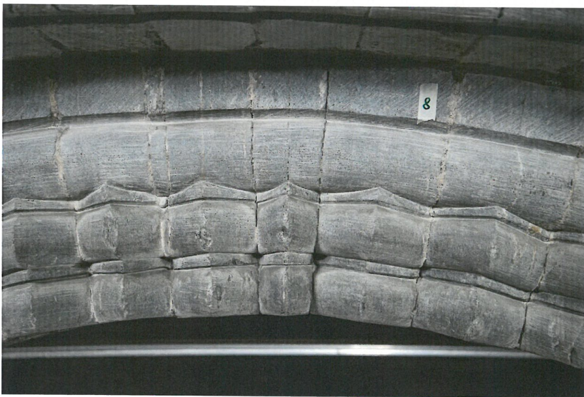
Figur 7: Topp første bueledd, sett fra nordre tverrskip. Legg spesielt merke til den samle steinen på midten, kilden som er satt inn samt uregelmessigheter langs nedre kant. Foto: HG.
