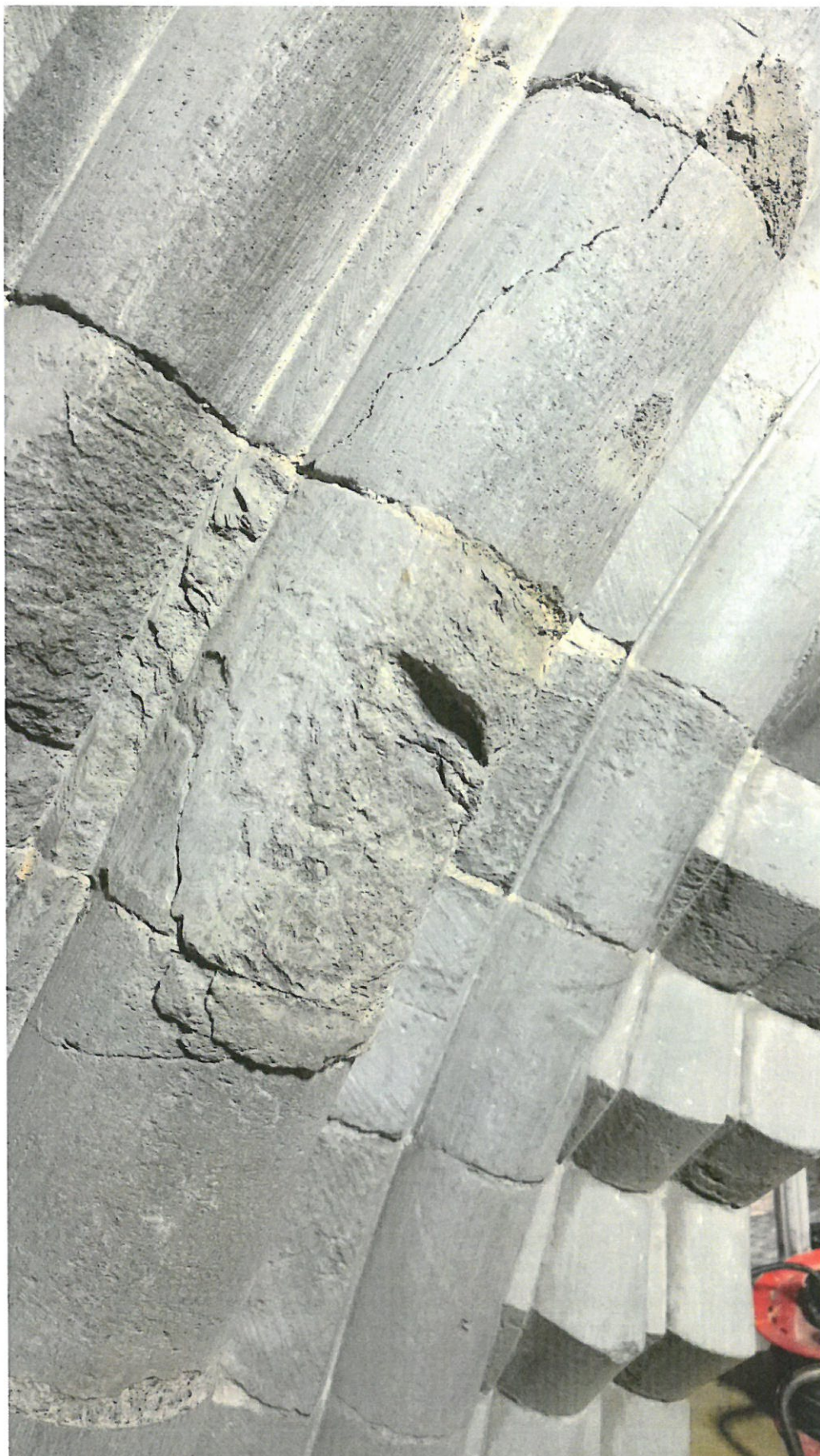
Figur 13: Forvitring og sprekk på buens nordre side. Foto: ES.
