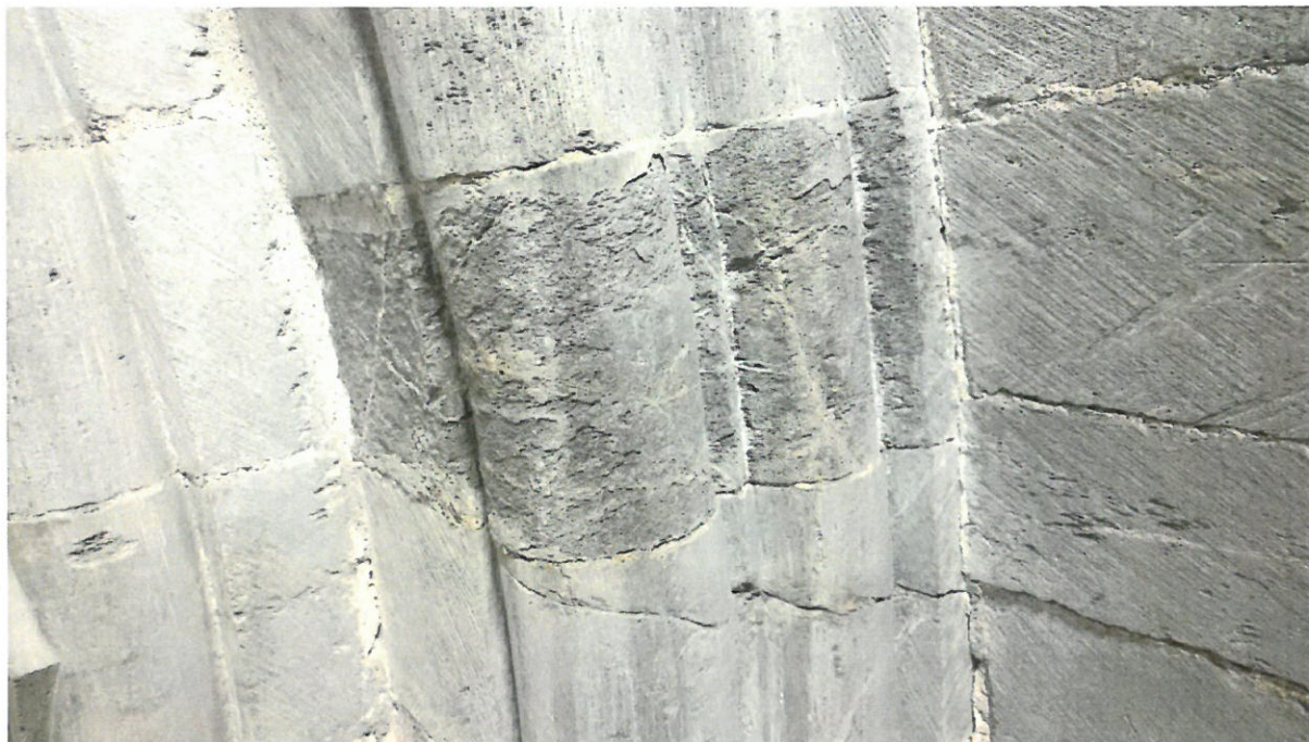
Figur 14: Forvitring og sprekk på buens søndre side. Foto: ES.
