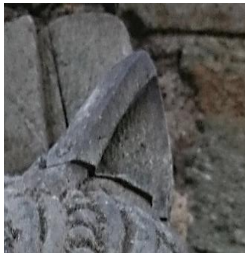
Figur 11. Tidligere reparasjon med åpne fuger.
