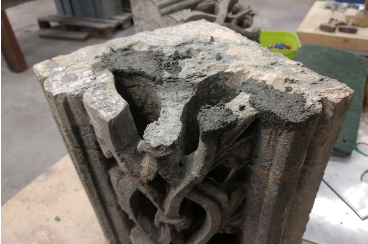
Mindre skader i fugeflaten repareres ved ettermodellering
