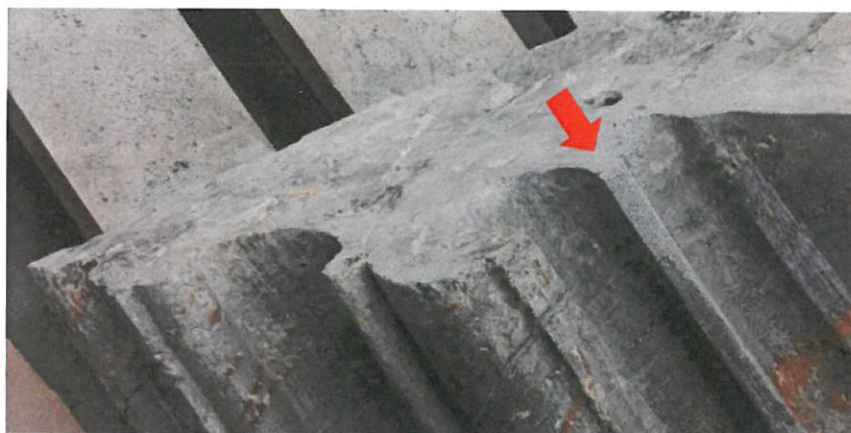
Figur 20. Rød pil peker på reparasjon med restaureringsmørtel på profil.
