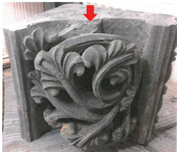
Figur 15. Rød pil markerer bruddskade i ornamentikken. Mot fugen er skader i profilet utbedret.
