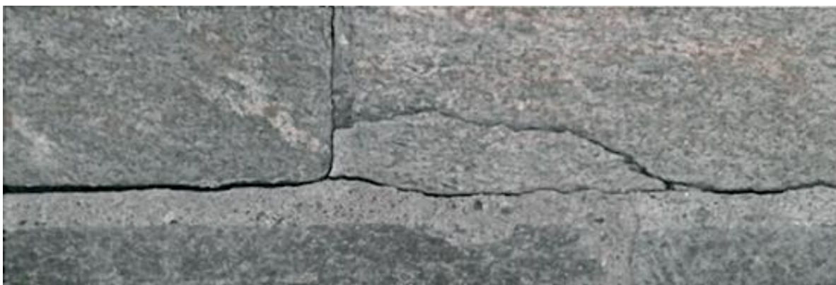
6 Eksempel på skader grunnet sementbruk (foto: NDR)
