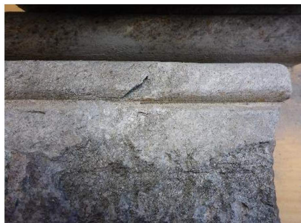
9 Skade på profil (foto: NDR)
